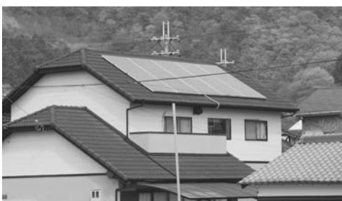
太陽光発電システム
