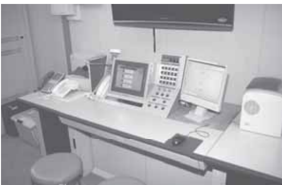
防災無線室（市役所本庁舎）
