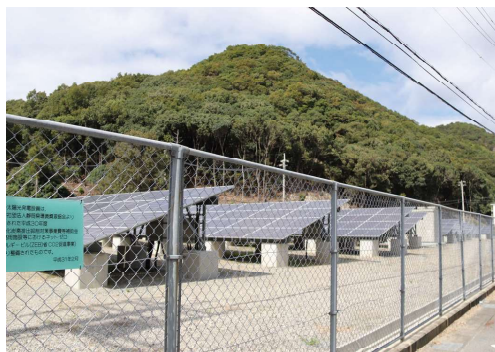
沢田前処理場の太陽光発電施設
