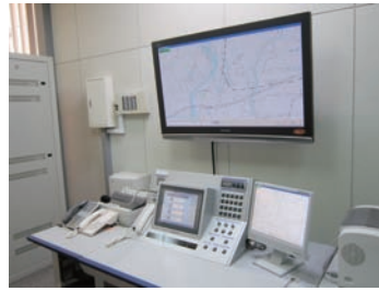
防災行政無線（操作卓）
