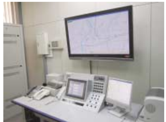
防災行政無線（操作卓）
