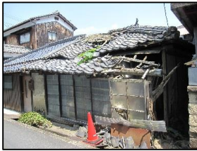
道路に面している長屋の空き住戸の屋根が崩落
