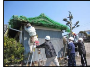
瓦の落下により屋根にネットを取付
