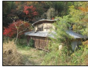
広い敷地内の家屋が老朽化（倒壊しても近隣への影響小）
