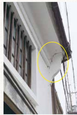
道路拡幅のため、軒切りされて出幅が短くなった持送り
