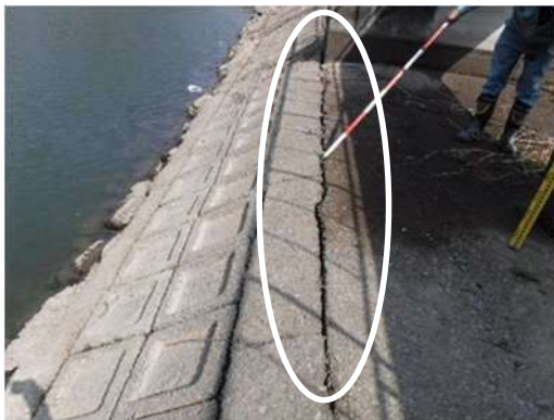
洪水吐流入部 ひび割れ
