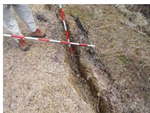
堤頂 ひび割れ
