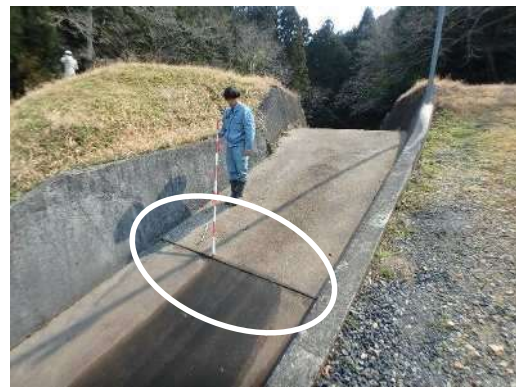
放水路部 漏水
