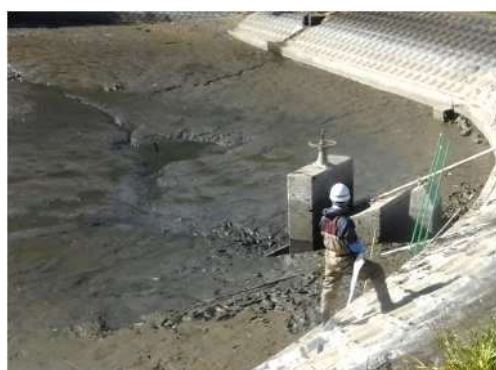
泥土堆積状況(かいぼり実施前)
