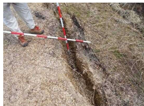
堤頂 ひび割れ
