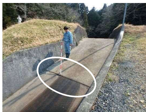
放水路部 漏水
