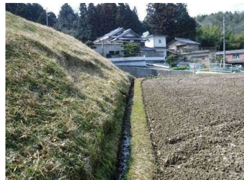
後法 はらみだし及び陥没
