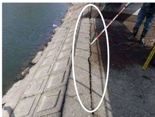
洪水吐流入部 ひび割れ
