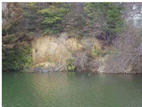
ため池周囲 土砂崩壊
