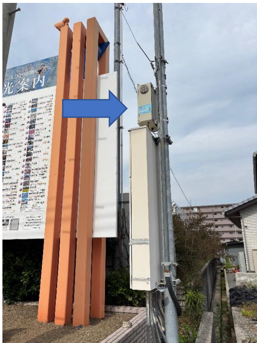
市設置の Wi-Fi ボックス
