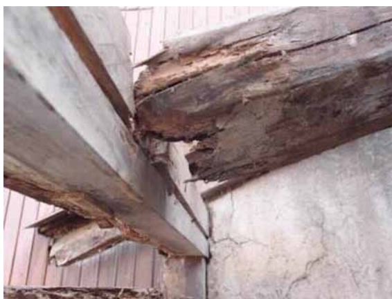
修理前。登り梁の老朽化が著しい
