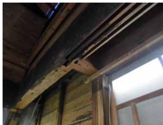
建具溝横に柱を切った後が残る
