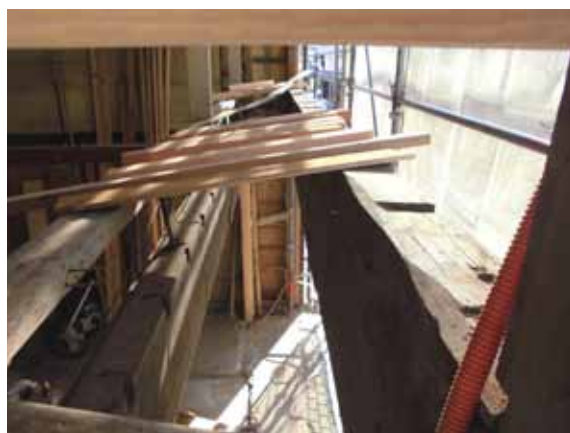
シャッター下に垂木痕が残っていた
