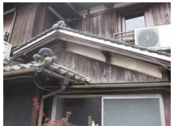
修理前の北面に旧寸法の板が一部残る
