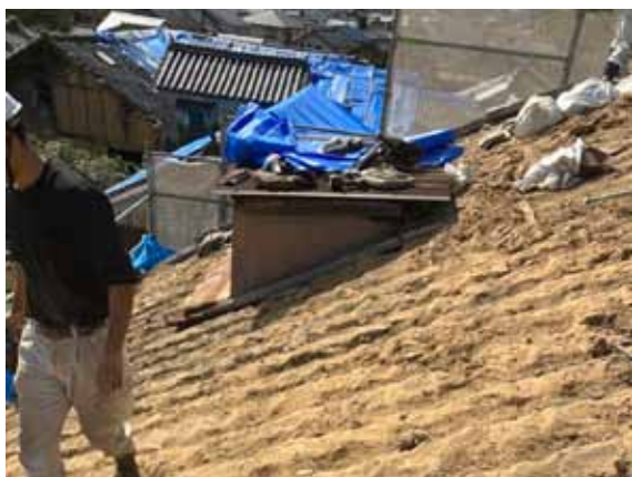
既存越屋根。板金に改造されていた
