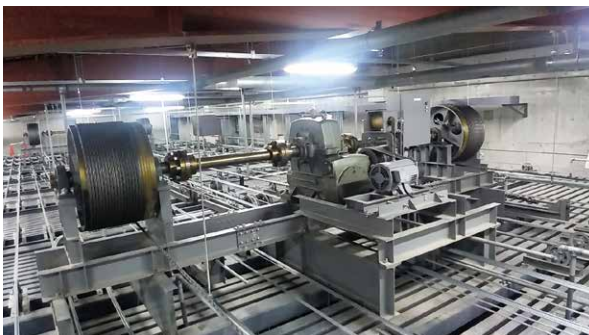
赤とんぼ文化ホール吊物設備
