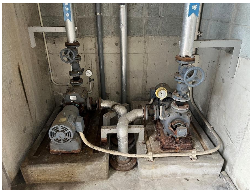
揚水ポンプ 2台 40MS362.2 (株荏原製作所製)
