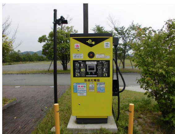
【西播磨県民局内急速充電器】
