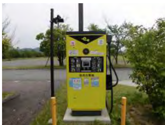
【西播磨県民局内急速充電器】
