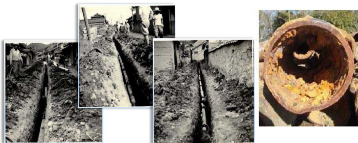
古くなった水道管
